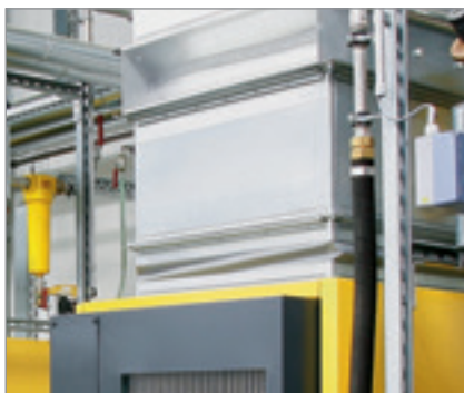
Figura 2: Conexión de ventilación del compresor con empalme de lona
