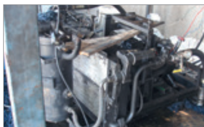
Figura 1: Estación de aire comprimido descuidada
