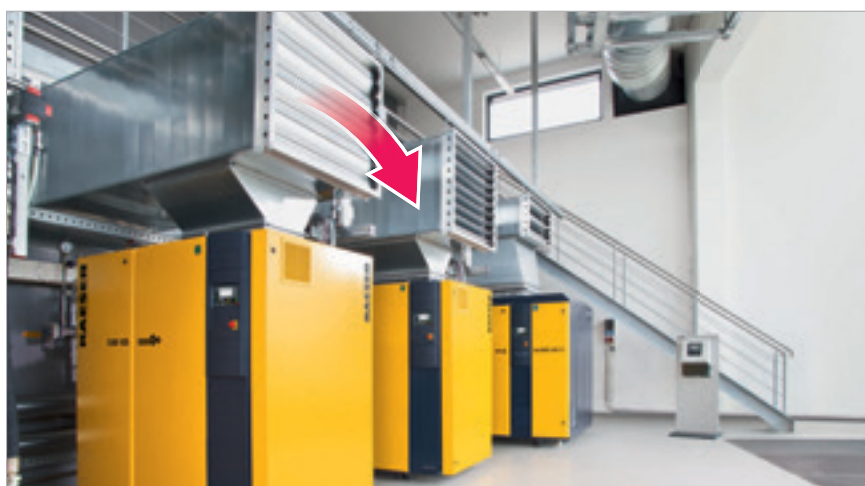
Figura 3: Estación de aire comprimido con circulación de aire controlada termostáticamente
